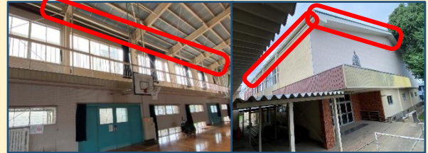
昨年度の豪雨の際、雨漏りがひどかった体育館。樋の改修工事を行いました！！
